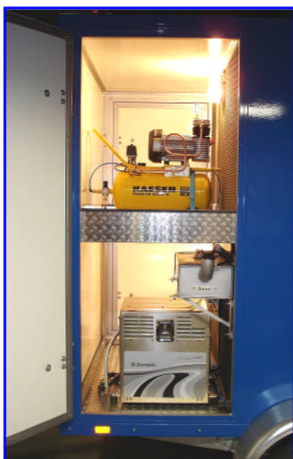
Maschinenraum mit Generator, Kompressor
